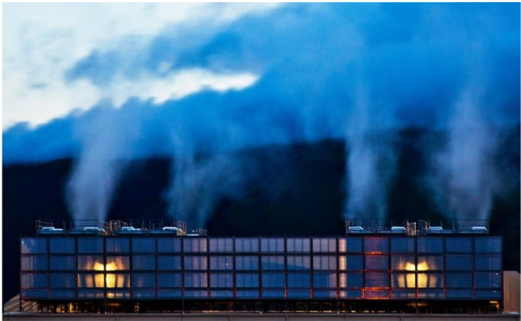
O vapor sobe acima das torres de resfriamento no data center de The Dalles, em Oregon. Essas plumas de vapor d'água criam uma névoa ao entardecer. Google foto
